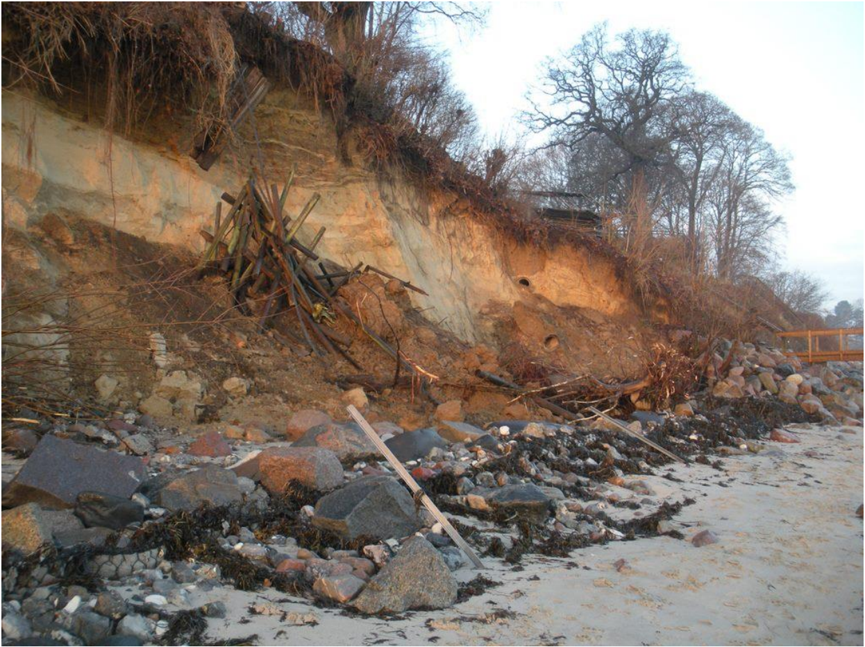
Foto nr. 2 af 11.12.2013: Store skred efter stormen Bodil i 2013. Fotoet er taget mod nord fra stranden på den sydlige del af Egtoftevej 10. Det viser kystskrænten på Egtoftevej 10. I baggrunden ses skråningsbeskyttelsen på den nordligste del af Egtoftevej 10 samt badebroen ved nordskel af Egtoftevej 10.
